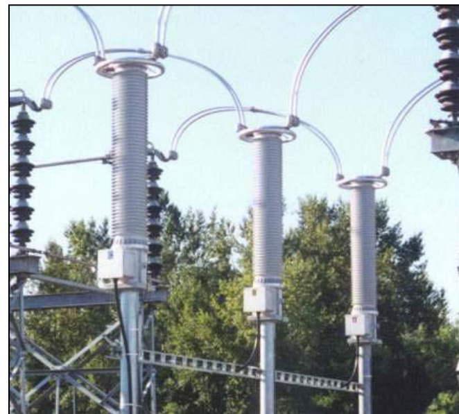
BC Hydro's Ingledow állomás – 230 kV Kombinált optikai mérőváltó
