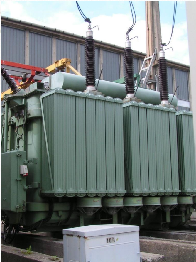
“Gép” transzformátor – erőművi blokk (step-up) transzformátor
