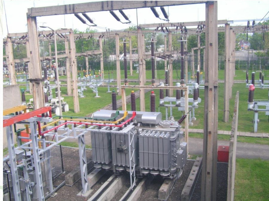
NaF/KöF állomási transzformátor (120/20 kV)
